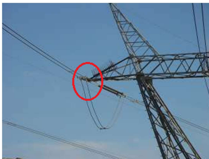
Figura nr.7. 2 Montare incorectă ce lasă expus spațiu de aterizare
